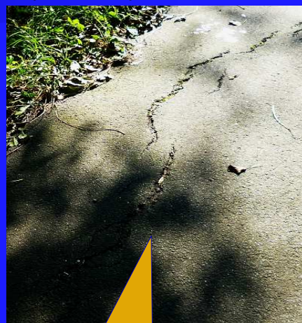
Versackungen, Risse, Radweg ist uneben
