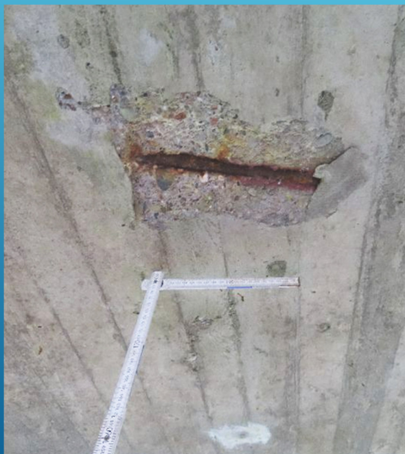
Abplatzungen, freiliegende Bew.
