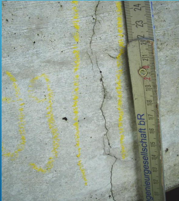
Risse im Beton
