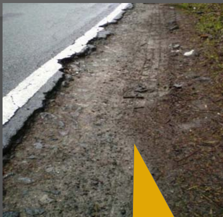
ausgefahrener Bankettbereich abgebrochene Fahrbahnränder
