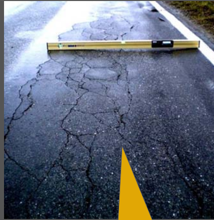
Netzrisse, Flickstellen, Spurrinnen
