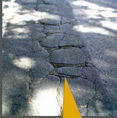
diverse Netzrisse, Ausbrüche, Flickstellen
