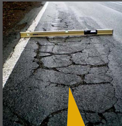
Netzrisse, Flickstellen, Spurrinnen
