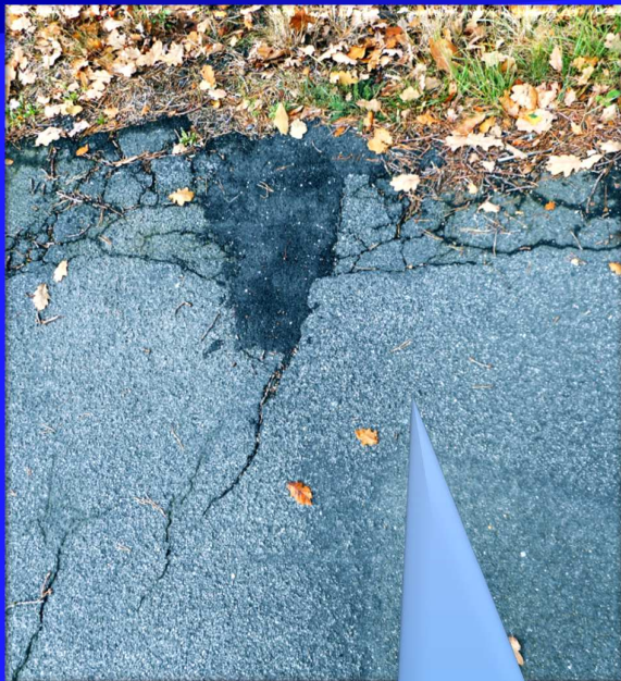
Randabbrüche, Netzrisse, Flickstellen
