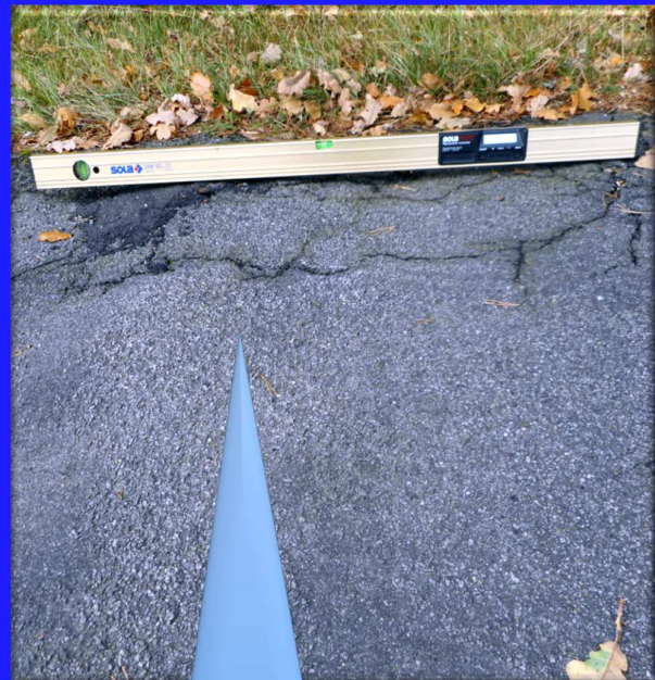
Versackungen, Netzrisse, Radweg ist uneben
