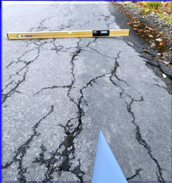
Versackungen im Randbereich, Kantenabbrüche
